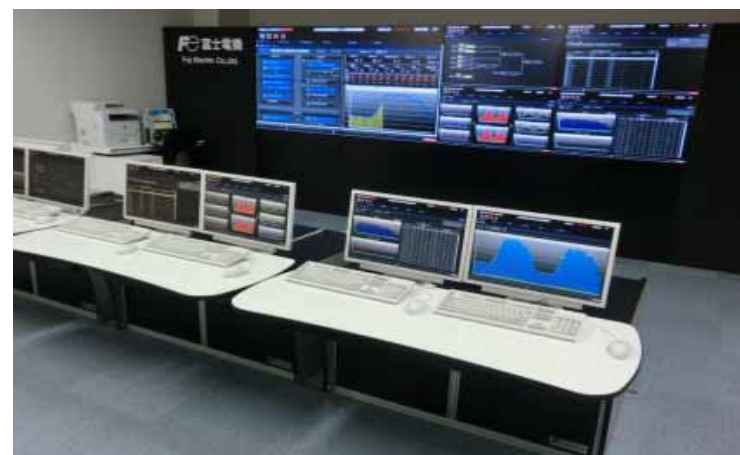
北九州のスマートコミュニティのコントロールセンター
